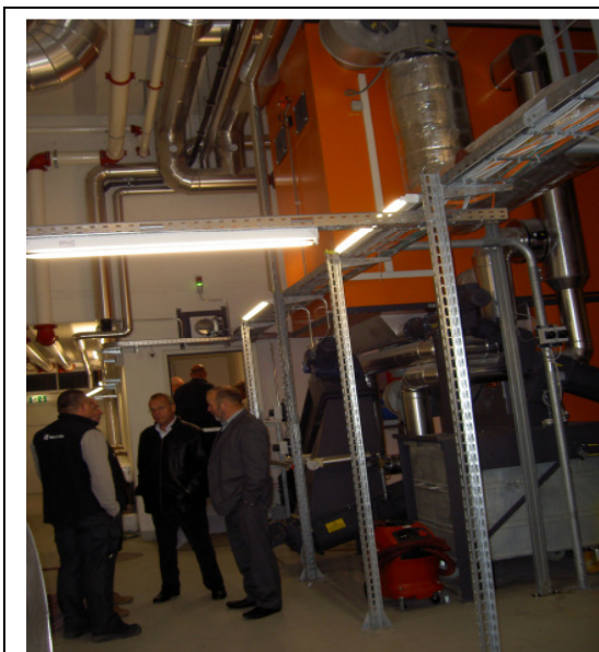
Die moderne Heizanlage verspricht einen hohen Wirkungsgrad
